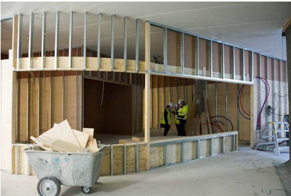
Ylimmän kerroksen akuuttiosastolla rakennustyöt ovat käynnissä vastaanottohuoneiden, potilashuoneiden ja kanslian osalta (kuva 4).
