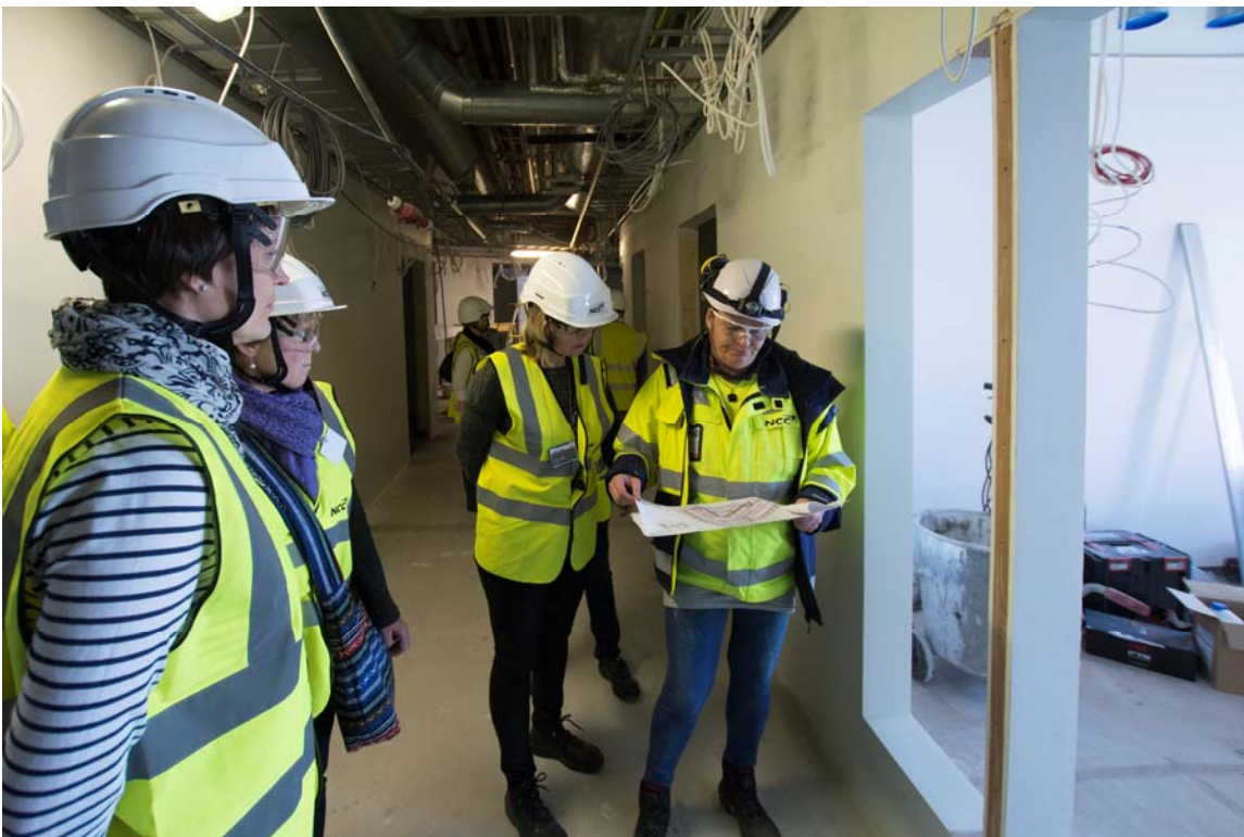
Neljännän kerroksen akuuttiosastolla asennustyöt jatkuvat. Kuvassa tulevia työntekijöitä tutustumassa tiloihin NCC:n asiantuntijan johdolla (kuva 2).
