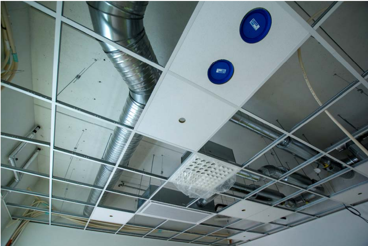
Tekniikkalevyjä asennettuna 3. kerroksen ATK-tiloissa (kuva 3).
